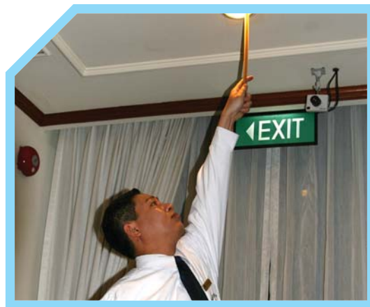
KIỂM TRA ĐÈN BÁO KHẨN CẤP
